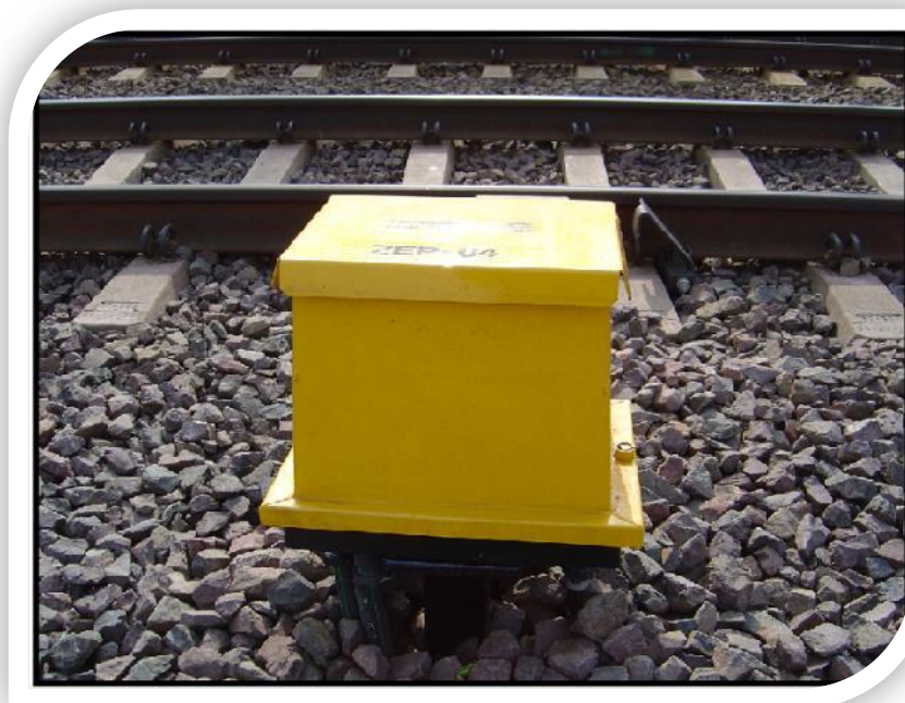
Puszka ochronna urządzeń przytorowych, SOT, EON
